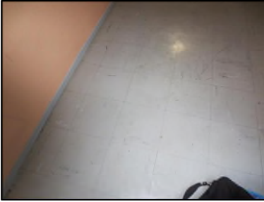
Photo N° 527 ECH-N°1 REVETEMENT DE SOL PALIER VOLEE ESCALIER +1 Planchers Dalles de sol 30x30 avec colle noire
