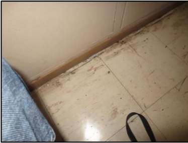
Photo N° 1285 REVETEMENT DE SOL --paliers +1 à +5 Planchers Dalles de sol 30x30 avec colle noire
