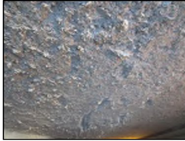
Photo N° 663 ECH-N°1 FLOCAGE -- LOCAL POUBELLE Plafonds Blanc cotonneux
