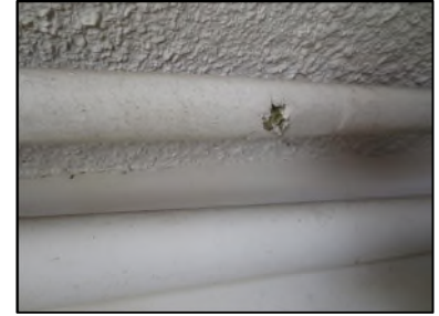
Photo N° 564 ECH-N°2 CALORIFUGEAGE PARKING Conduits de fluide Laine minérale + enveloppe bituminée
