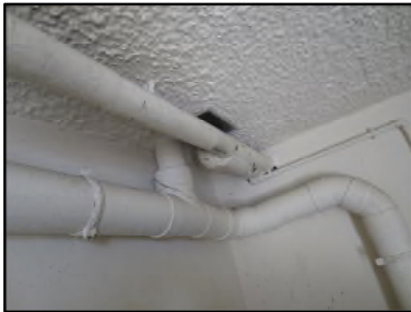
Photo N° 566 ECH-N°3 CALORIFUGEAGE Local poubelles_S.sol Conduits de fluide Laine minérale + enveloppe bituminée
