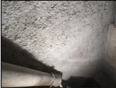
Photo N° 32 ECH-N°1 FLOCAGE PREHAUT_RDC Plafonds COTONNEUX BLANC
