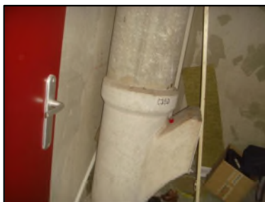
Photo N° 6101 AMIANTE CIMENT -- local vo -1 à +2 Vide-ordures Gaine V.O.(Fibres-ciment)
