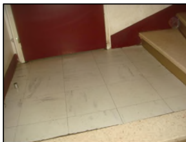
Photo N° 6085 REVETEMENT DE SOL --paliers +1 à +4 Planchers Dalles de sol 30x30 avec colle noire
