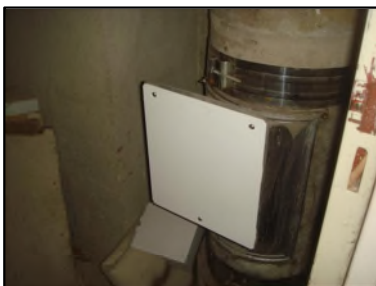
Photo N° 6054 AMIANTE CIMENT - -local vo -1 à +2 Vide-ordures Gaine V.O.(Fibres-ciment)
