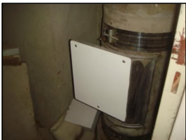
Photo N° 6054 AMIANTE CIMENT - -local vo -1 à +2 Vide-ordures Gaine V.O.(Fibres-ciment)
