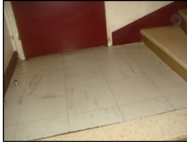
Photo N° 6085 REVETEMENT DE SOL --paliers +1 à +4 Planchers Dalles de sol 30x30 avec colle noire
