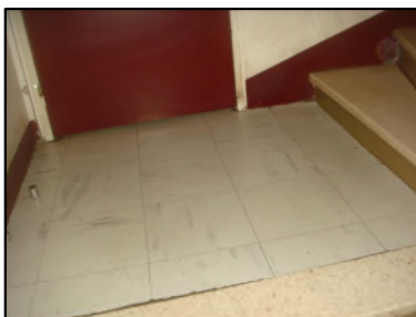
Photo N° 6085 REVETEMENT DE SOL --paliers +1 à +3 Planchers Dalles de sol 30x30 avec colle noire
