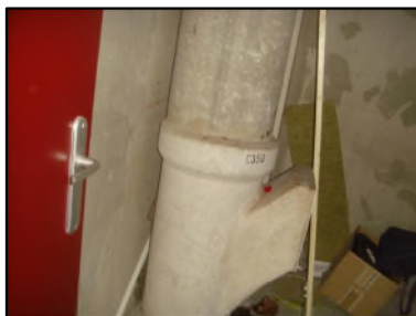
Photo N° 6101 AMIANTE CIMENT - -LOCAL VO -1 à +3 Vide-ordures Gaine V.O.(Fibres-ciment)
