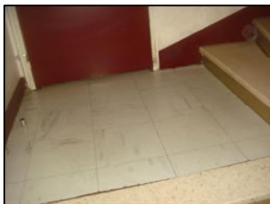
Photo N° 6085 REVETEMENT DE SOL --PALIERS +1 à + 3 Planchers Dalles de sol 30x30 avec colle noire
