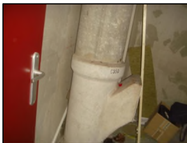
Photo N° 6101 AMIANTE CIMENT - -LOCAL VO -1 à +3 Vide-ordures Gaine V.O.(Fibres-ciment)
