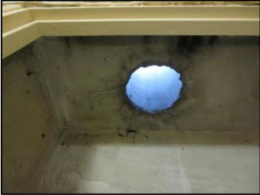
Photo N° 1295 AMIANTE CIMENT - -PLACARDS TECH +6 Plafonds Ventilation haute (Fibres-ciment)
