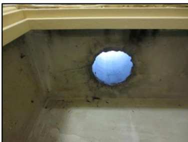
Photo N° 1295 AMIANTE CIMENT - -PLACARDS TECH +5 Plafonds Ventilation haute (Fibres-ciment)
