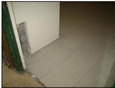
Photo N° 11 ECH-N°3 REVETEMENT DE SOL --Local courrier Planchers Dalles de sol blanche 30x30 avec colle noire
