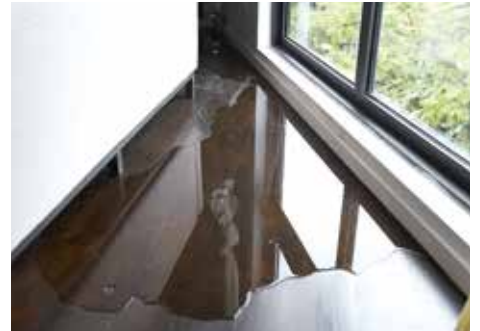
▲ En cas de dégât des eaux, l'humidité peut engendrer des moisissures et des problèmes de santé pour les occupants.
